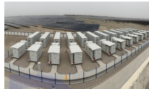
大型光伏配储项目
