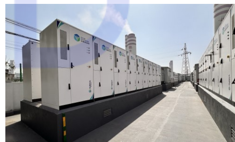
工业园区配储项目
